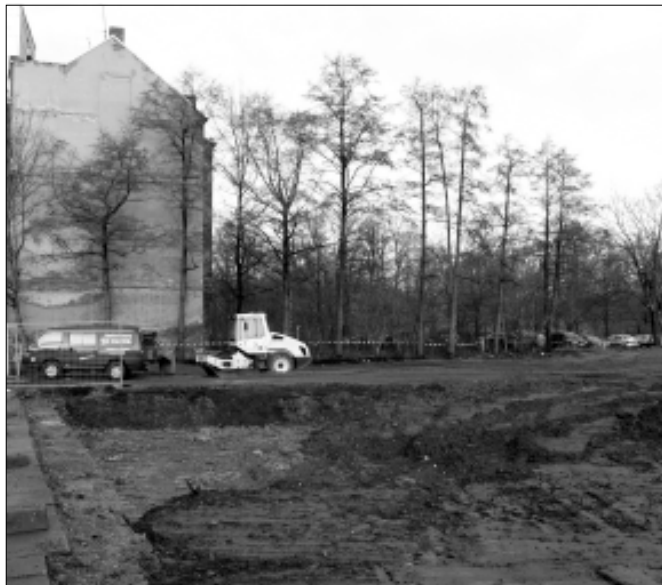
Zur Neugestaltung des Uferparks wurde die Ruine Schlossstraße 7 abgerissen. Das Grundstück wird gegenwärtig freigelegt und in das Nutzungskonzept einbezogen. Die Freilegung des Nachbargrundstückes befindet sich in Vorbereitung.
