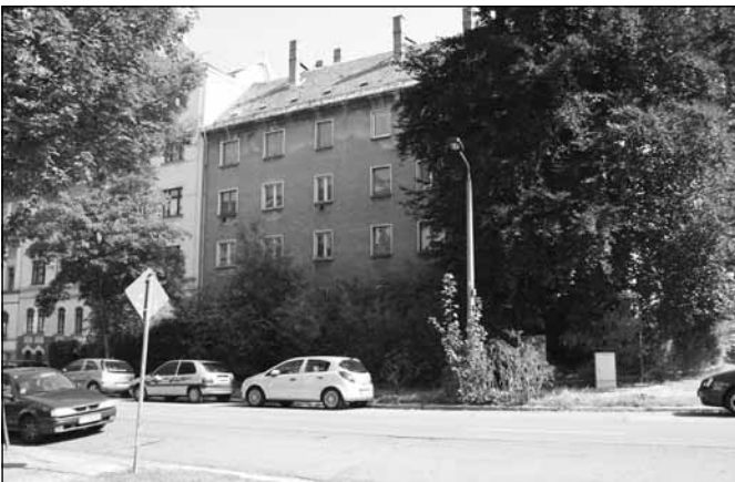
Kaßberg, Franz-Mehring-Straße 40: Komplettsanierung im unbewohnten Zustand. Leistungsinhalte: Grundrissänderungen, Balkonanbau, Erneuerung Haustechnik und Fenster, Wärmedämmung Fassade
